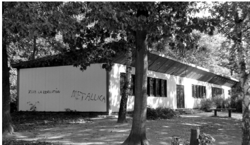
Hefigst in die Kritik geraten: Der Schulpavillon an der GGS Niederzier ist morgens nur kurz beheizbar, mieft und ist feucht.
